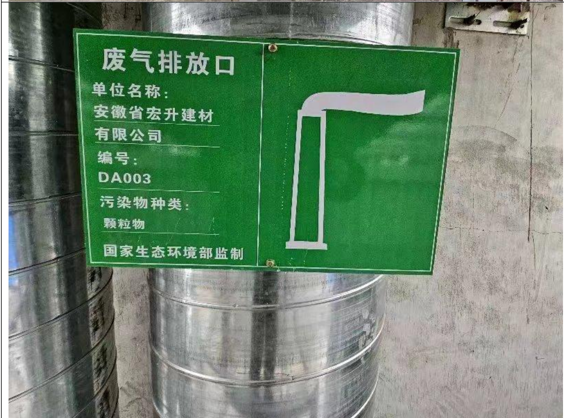
布袋除尘器+15m 高排气筒（DA003）
