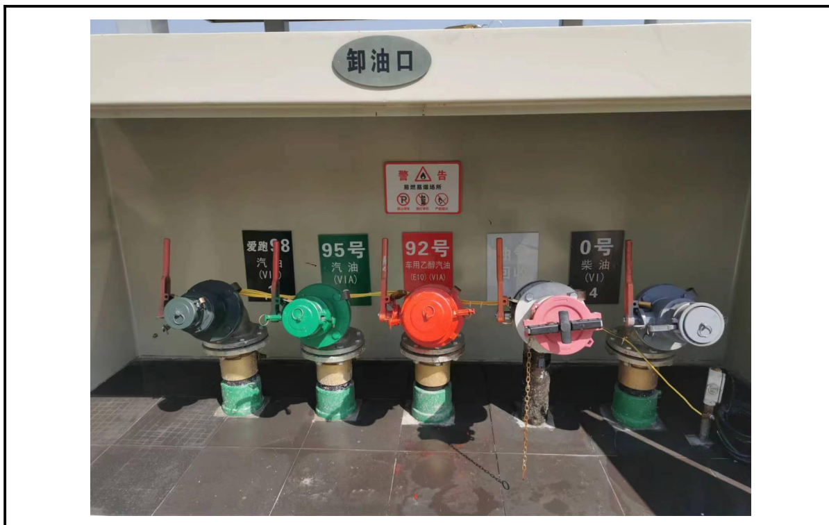
图4-2 油气回收装置
