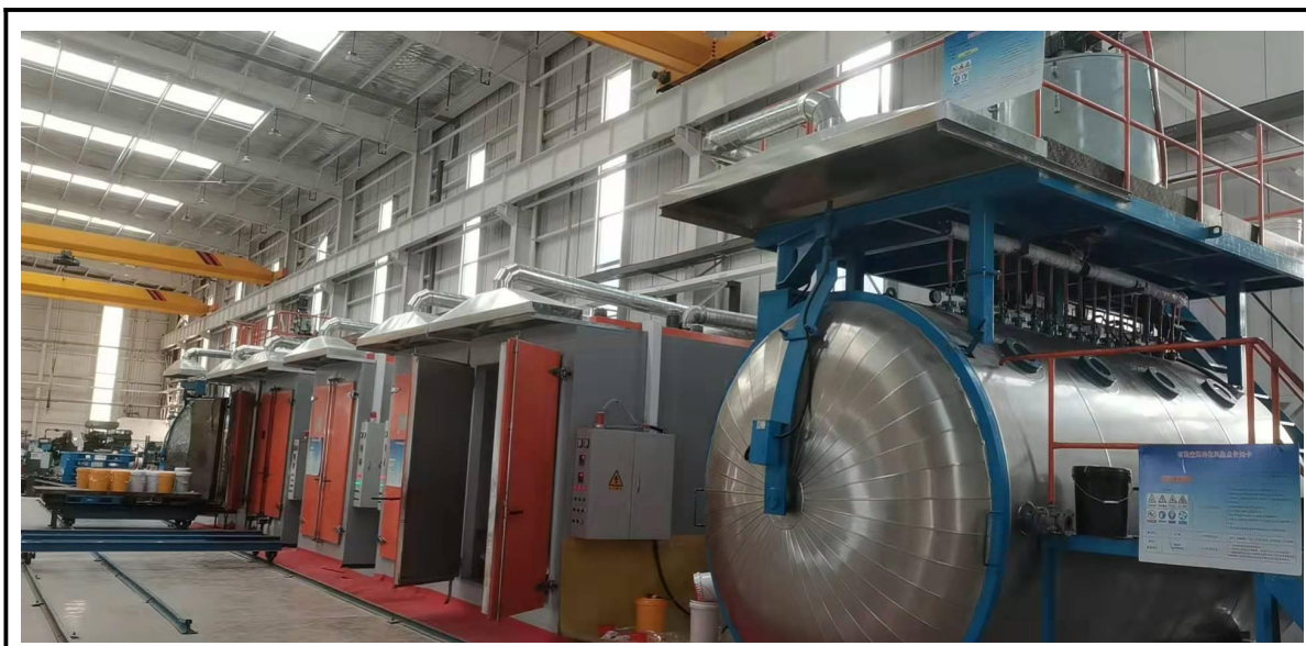
图4-1 固化废气环保设施及环保标识牌
