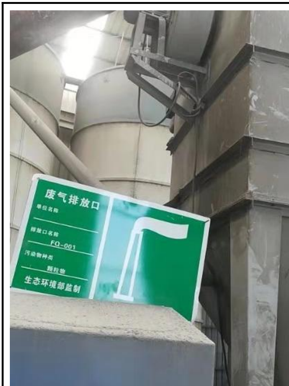
图4-6 废气排放口标识牌
