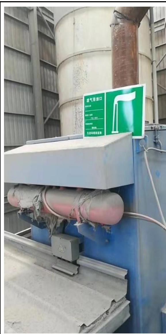
图4-5 废气排放口标识牌
