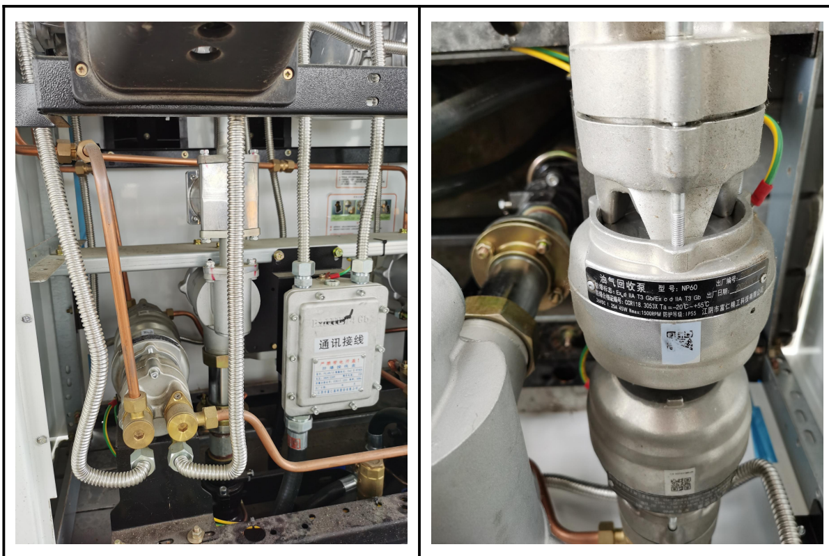
图4-1 油气处理系统环保设施及环保标识牌
