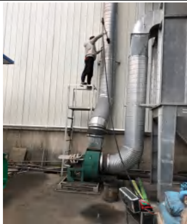
1#排气筒有组织废气监测采样
